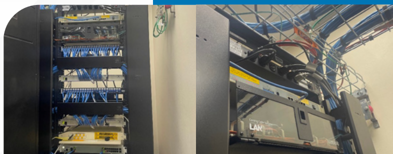
Centro de cableado de la sede central.
