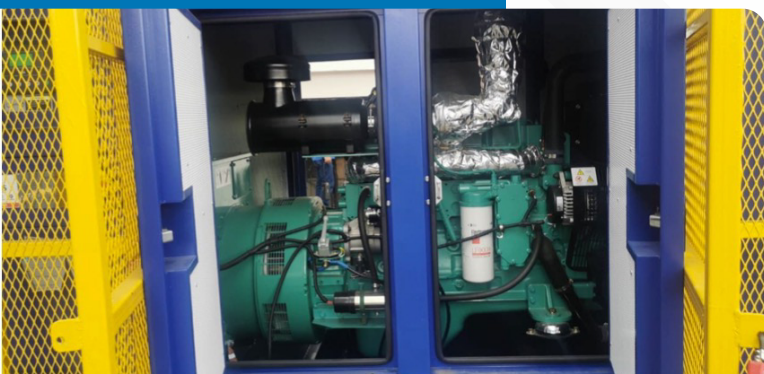
Generador eléctrico del Colegio que puede trabajar 17 horas de forma continua.
